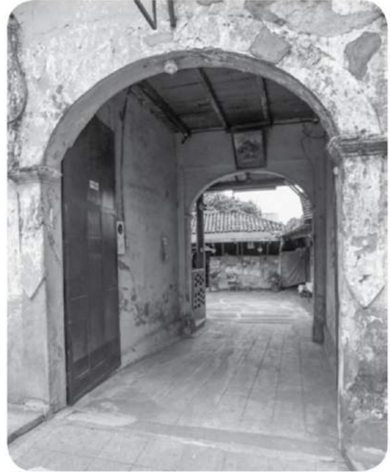
Puerta y zaguán de la casa, en deterioro, 1890.
